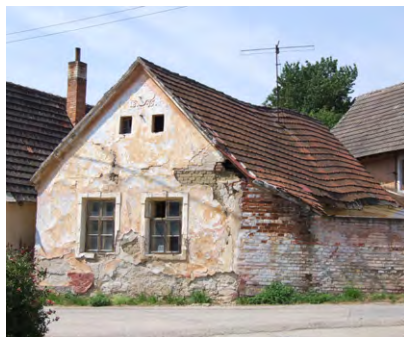
Sobotište (Záhorie), dlhodobo opustený a nevyužívaný murovaný dom (nepálená a pálená tehla). Foto: M. Dudáš
