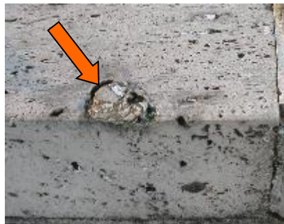
Nažloutlý tmel použitý při rekonstrukci vily v 80-tých letech 20. století
