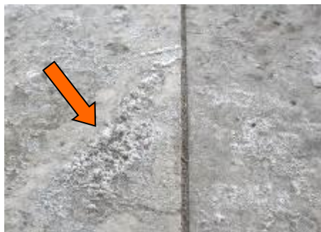
Jeden ze specifických typů poškození dlažby – výkvěty solí
