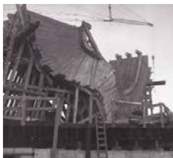
Rovnováha, Barrandovský most, proces stavby Autor: Josef Klimeš Fotografie: z pozůstalosti autora
