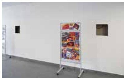
Otvory v sadrokartóne pre prvotné zistenie prítomnosti a stavu reliéfnnej steny. Vstupná hala v závode Figaro – dnes Mondelēz na Račianskej ulici 44 v Bratislave.
