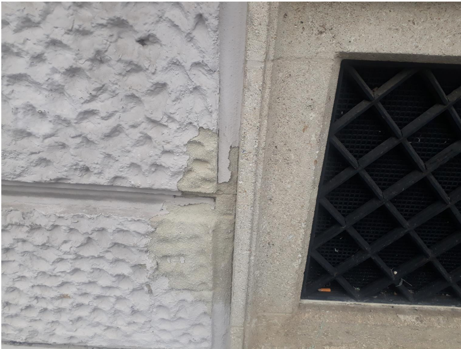
Dichte Sockelputze, dichte Kellerfenster, keine Kellerbelüftung
