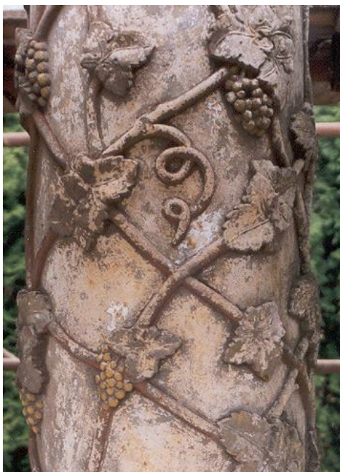
Stav před čištěním
