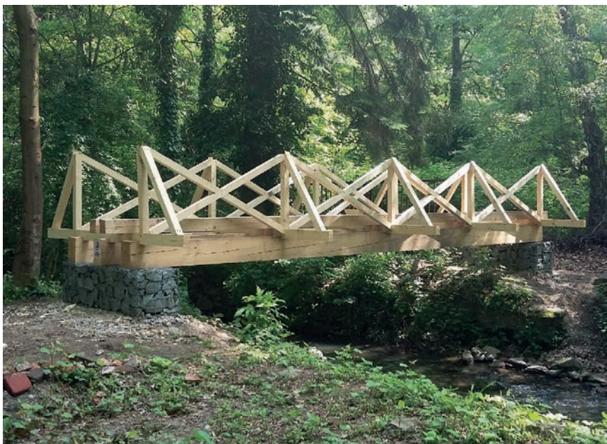
Výstavba prvého provizórneho premostenia, ktorým sa opätovne spojil Malý a Kaštieľský park, rok 2016. Zdroj: archív autora
